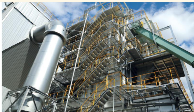
那珂川バイオマス発電所
